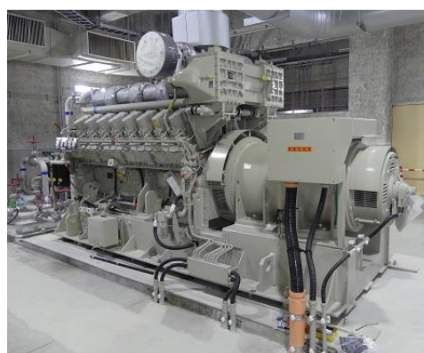
非常用自家発電機（北茂安浄水場）
